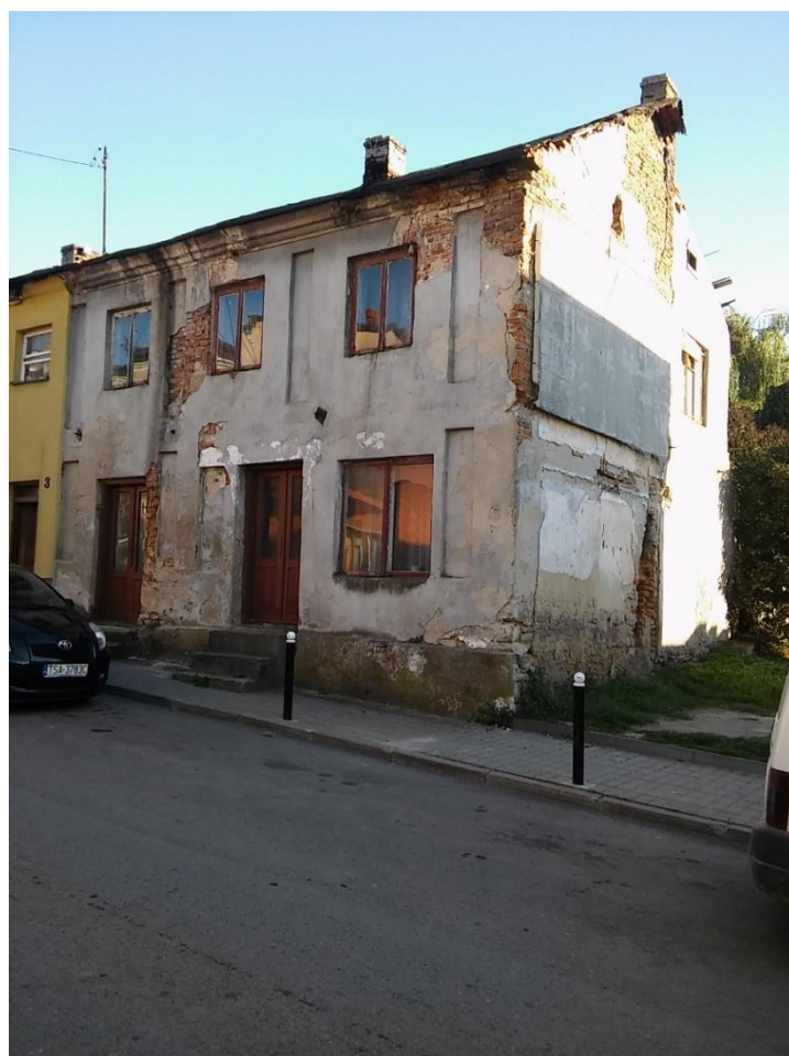
Zniszczone budynki mieszkalne w centrum Klimontowa
