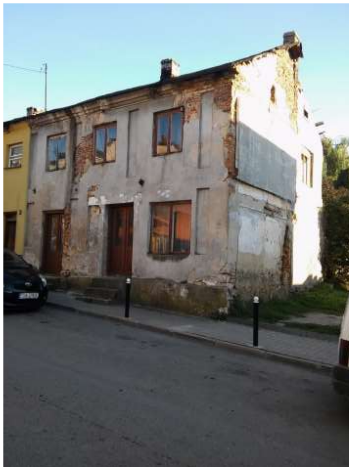
Zniszczone budynki mieszkalne w centrum Klimontowa
