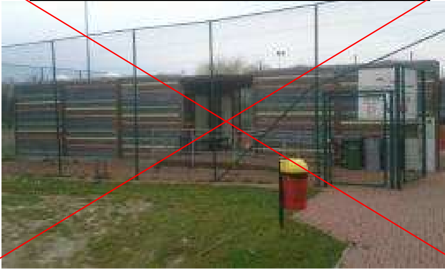
Widok kontenerów zaplecza boiska wielofunkcyjnego – do remontu
